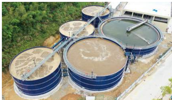
福建泉州污水应急处理项目
