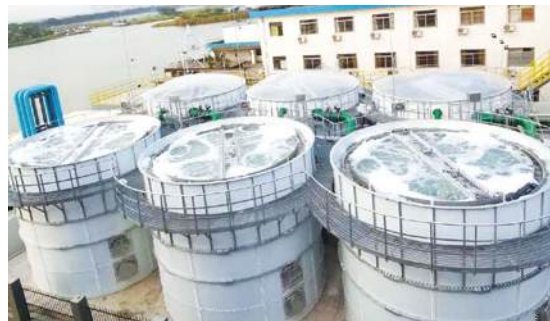
广东汕头市政污水处理项目
