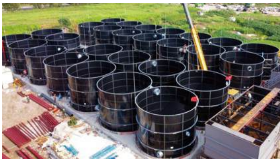
江苏吴中生活废水应急处理项目
