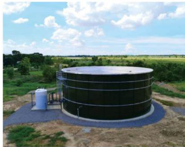
▽ 泰国饮用水储存罐
